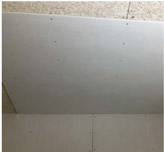
Trockenputz: Knauf Bauplatte GKB 12,5 mm auf Heraklith BM befestigt mit Knauf Schnellbauschrauben TN (Länge: Wand 90 mm, Decke 70 mm).
