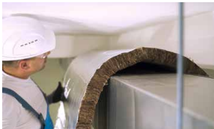
Isolatie van rechthoekige luchtkanalen
