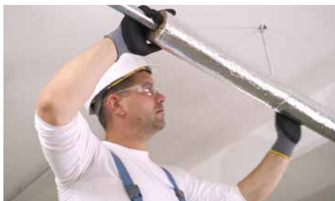
Isolatie van leidingen
