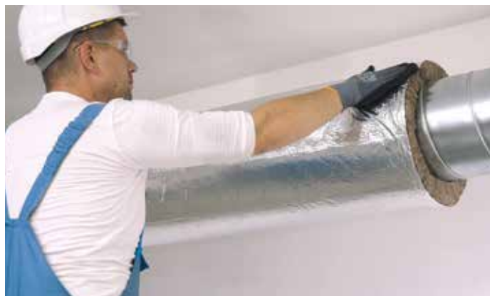
Isolatie van ronde luchtkanalen
