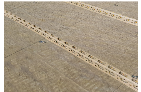
Drunterleisten auf Tektalan Platten (Drunterleisten so verlegen, dass die offenen Kanten zur Bewehrung zeigen)
